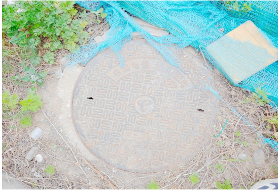
项目内通信检修井
