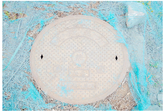
项目内热力检修井
