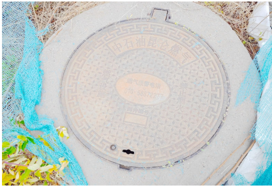
项目内燃气检修井
