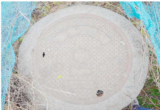
项目内上水检修井
