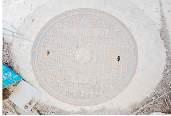
项目内电力检修井
