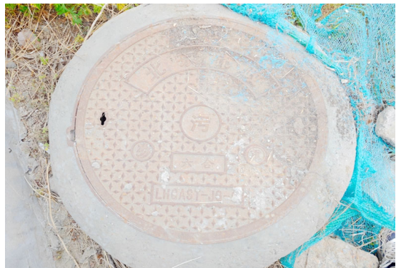
项目内下水检修井
